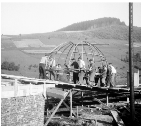
Obr.1: Instalace těžké konstrukce kopule v létě roku 1949 byla náročnou ruční prací. Foto: archiv hvězdárny
