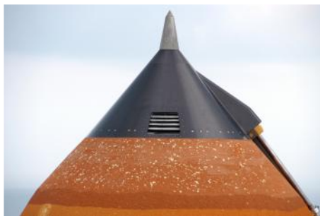
Obr.1: Poškození tepelné izolace na vrcholu vnější nádrže ET způsobené silným krupobitím 26. února 2007. [9]
